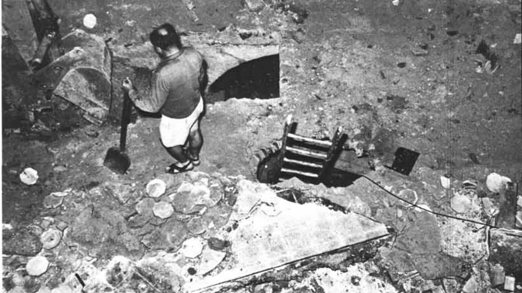
Abb. 1: Im Bild links die Baggerschaufel, die den Fußbodenbelag (Reste im Vordergrund) wegriß und dabei das Gewölbe der Herberstorffgruft aufriß; Blick auf den freigelegten Zugang zur Gruft.
