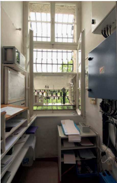
Abb. 7: Blick ins Wetterkammerl mit TAKLIS-Zentrale an der rechten Wand
