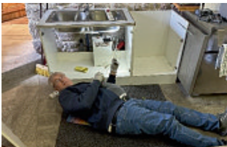
Austausch der alten Arbeitsplatte der Abwasch im Gewölbe: Kollingbaum Hans, Wimbauer Gerhard
