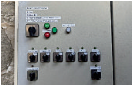
Aufbau und Anschließen der Automatik-Beleuchtungssteuerung: Mader Josef, Wimbauer Gerhard
