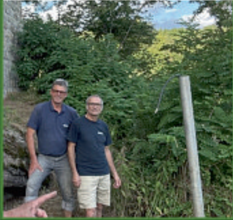
Nur das Foto ist schief: Einbetonieren der Ständer für die Außenbeleuchtung: Nenning Franz, Schwaiger Andi
