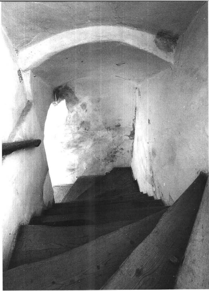
Abb. 17 Pfarrhof Buchkirchen, abge- brochene Treppe im Westtrakt
