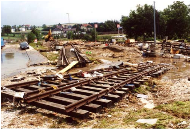
Im Bild, die bei der Hochwasserkatastrophe im August 2002 zerstörten Gleisanlagen des Schwertberger Bahnhofs.
